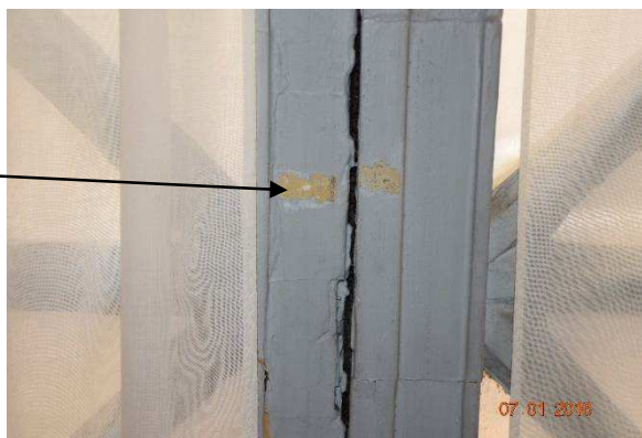
Sondage sur huisserie de la porte extérieure
